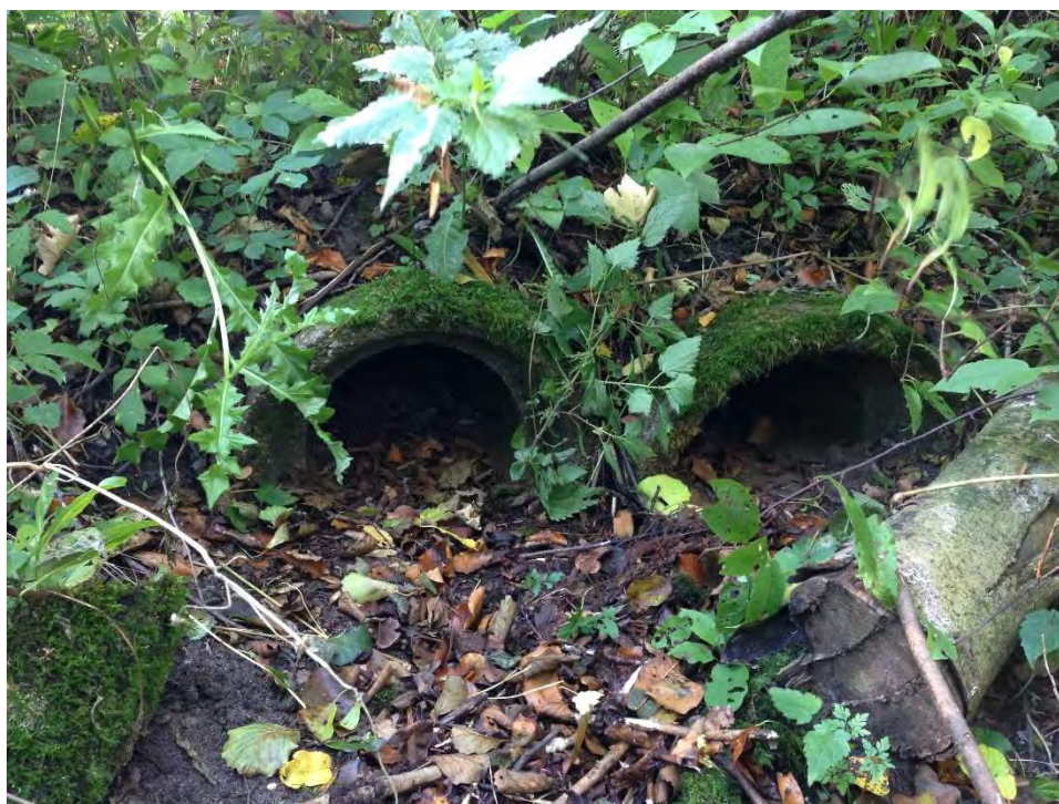
Figur 9. Krydsning af skovsti. Vandløbstracéet er helt tørt uden vandløbsvegetation, som indikerer, at der ikke har været rindende vand i forløbet igennem længere tid.
